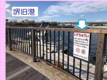
ウッドデッキのトゲでケガが多発。取り急ぎ注意喚起を掲示
