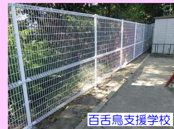
崖(写真奥)に傾いた校庭の危険なフェンスを新しいものに。
