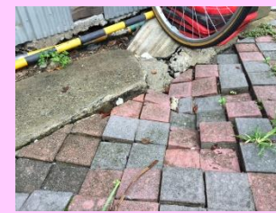
道路脇のブロック陥没を 即日調査、翌日修復
